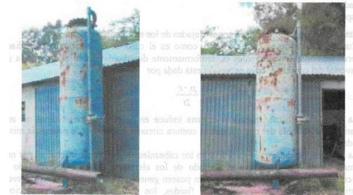
Fig. 1.- Tanque acumulador de aire comprimido. Fuente: P. Ciancio, M. Godoy, L. Arrien, 2004
